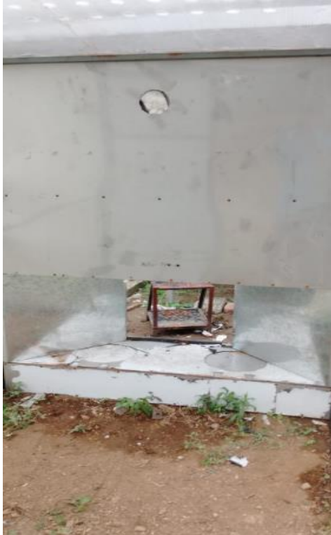
Ensamble de las paredes Venturi
