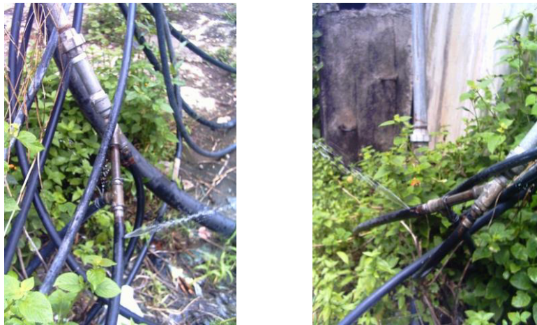
Foto 4 Rotura de manguera y mal ajuste de las llaves de registro
