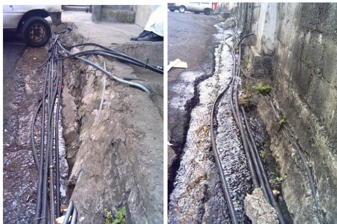
Foto 20 En el callejón 12 de octubre se encontraron más de 15 mangueras flex de ½” conectadas ilegalmente a varias de las guías múltiples de ½”.
