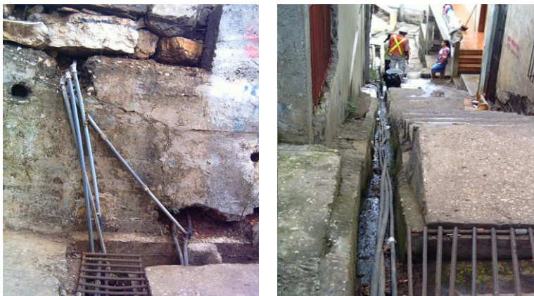
Foto 19. Conexiones ilegales. Estas conexiones se alimentan directamente de la línea de impulsión.
