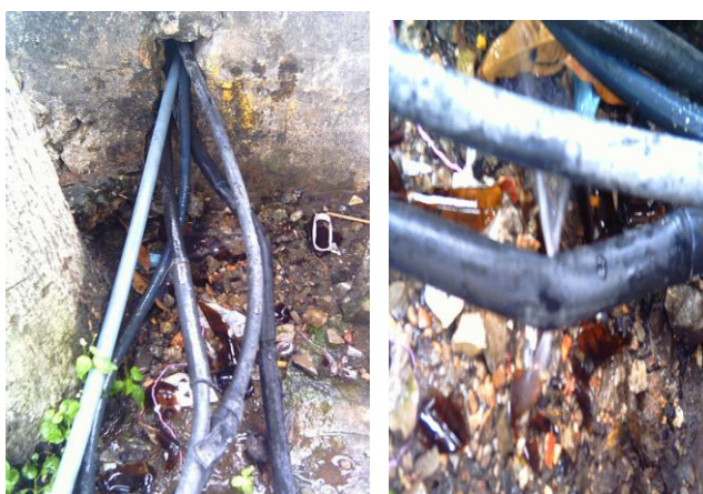
Foto 5 Conexiones ilegales en mal estado y rotura de tuberías PVC de \frac{3}{4} ".
