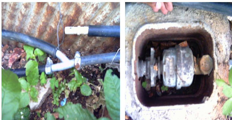
Figura 16. Medidores en mal estado.
