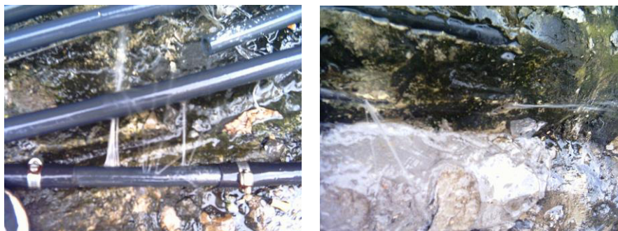
Foto 8 Callejón 12 de octubre, fugas visibles debido a roturas y malas conexiones
