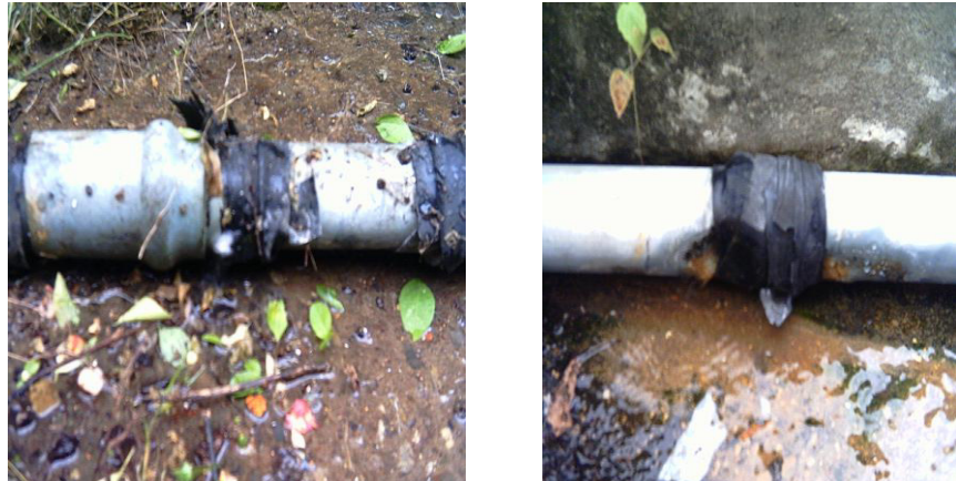
Foto 3 Fugas existentes causados por las malas uniones
