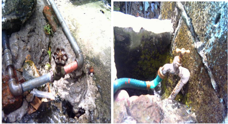
Foto6. Emilio Estrada y Callejón 15 llaves que no están debidamente cerradas
