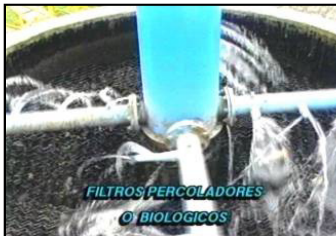
Figura 1.14 Tratamiento secundario: Filtros Percoladores Biológicos (26) .
