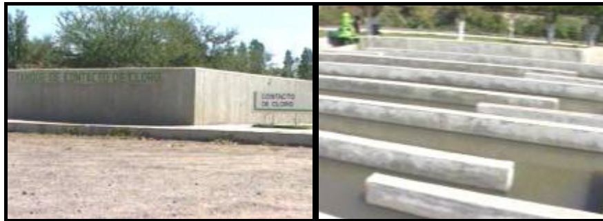
Figura 1.9 Unidad de Cloración instalada en un Sistema de Tratamiento de Aguas Residuales de la ciudad de México (19) .
