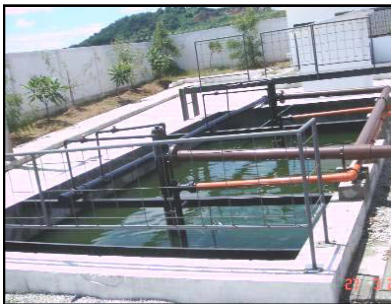
Figura 2.6 Vista del área superficial de un clarificador de dos tolvas (72) .
