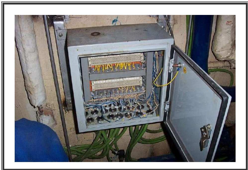
Figura No. 7.27 Caja de paso de la Bomba de Alimentación Principal
