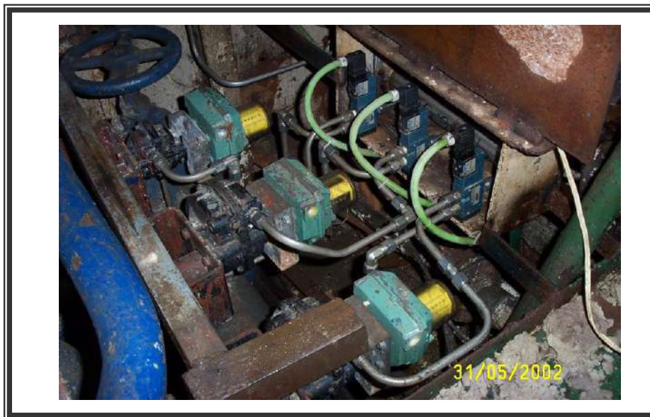
Figura No. 7.20 Válvulas de salida de agua de los tanques de reserva
