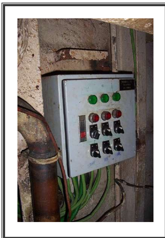
Figura No. 7.21 Caja de paso de tanques de reserva
