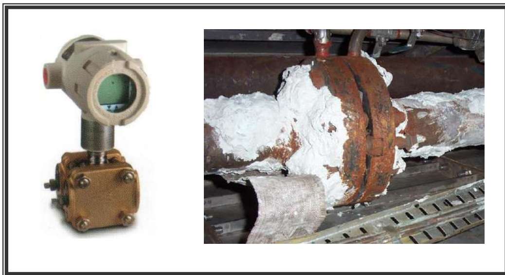
Figura No. 7.12 Medidor de Flujo y Placa Orificio de Agua de Alimentación
