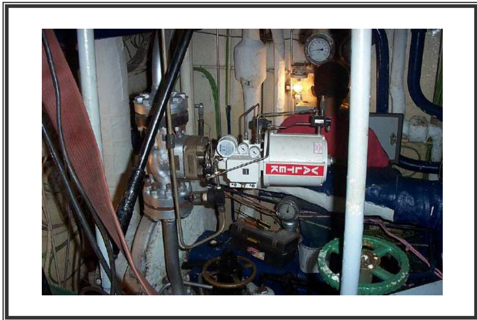
Figura No. 7.22 Válvula de Suministro de vapor a la Bomba de Alimentación Principal
