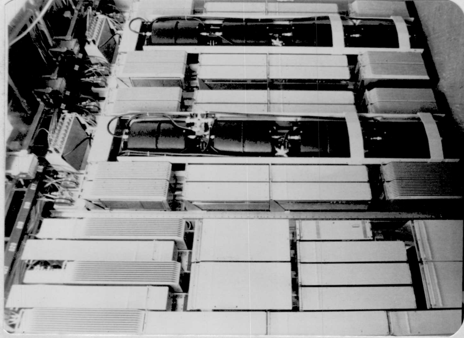
FIGURA 27.- CONFIGURACION DEL EQUIPO DE UNA ESTACION BASE.
