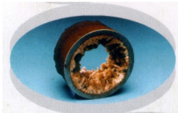
Fig. 1.1 Muestra de tubería incrustada.
