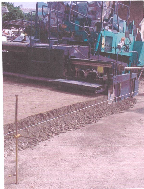
Foto 51 No se logra confinamiento de bordes
