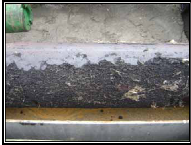
Figura 2.7 Incrustaciones en las paredes de una bomba
