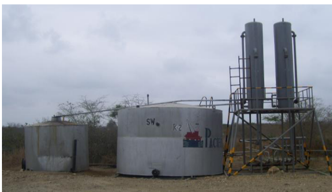
FIGURA 5.3 TANQUES DE ALMACENAMIENTO EN LAS SUBESTACIONES
