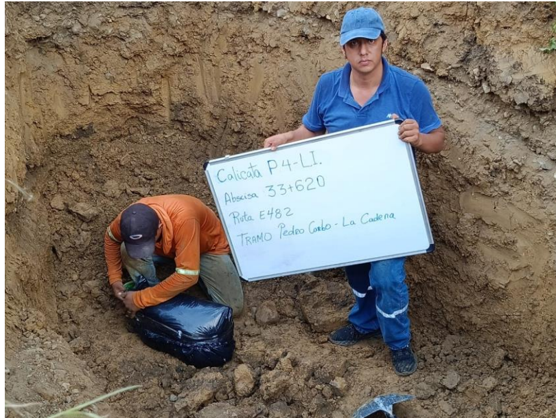
Figura 19. Calicata en C1 33+620 Lado Izquierdo.
