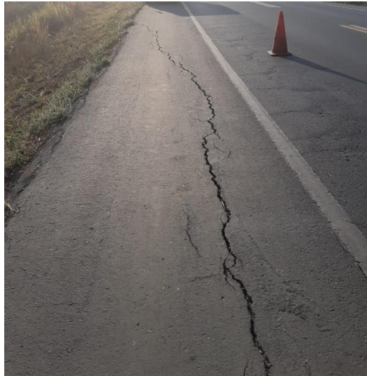
Figura 3. Fisuración de Borde.
