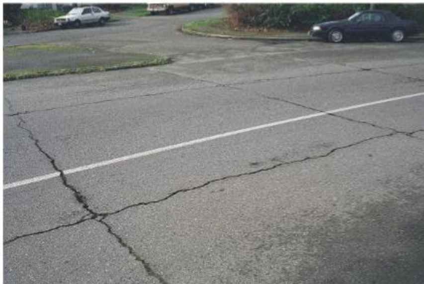
Figura 6. Fisuración por reflexión de juntas. Fuente: (Valdés et al., 2012)
