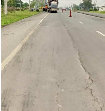
Figura 5. Fisuración longitudinal descendente/descendente.
