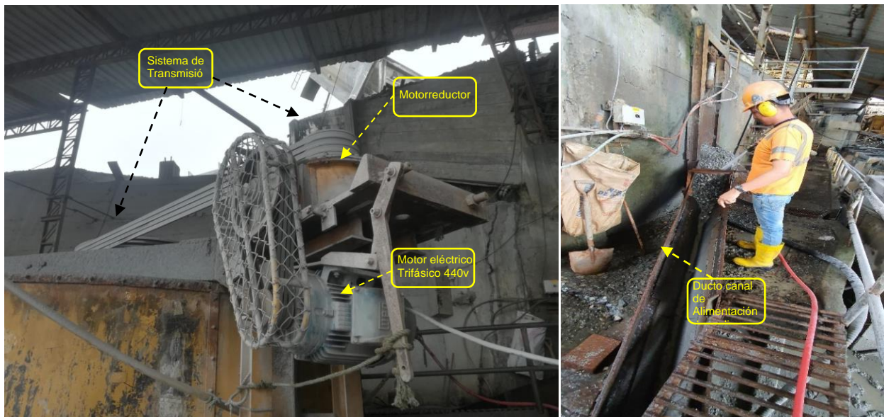
Figura 4.3 Motorización y sistema de transmisión y alimentación manual de molinos [Autor]
