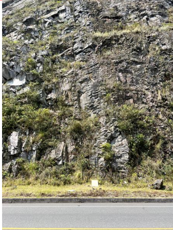
Imagen 6: Imagen del talud 2 donde se observa fragmentos de roca que han caído.
