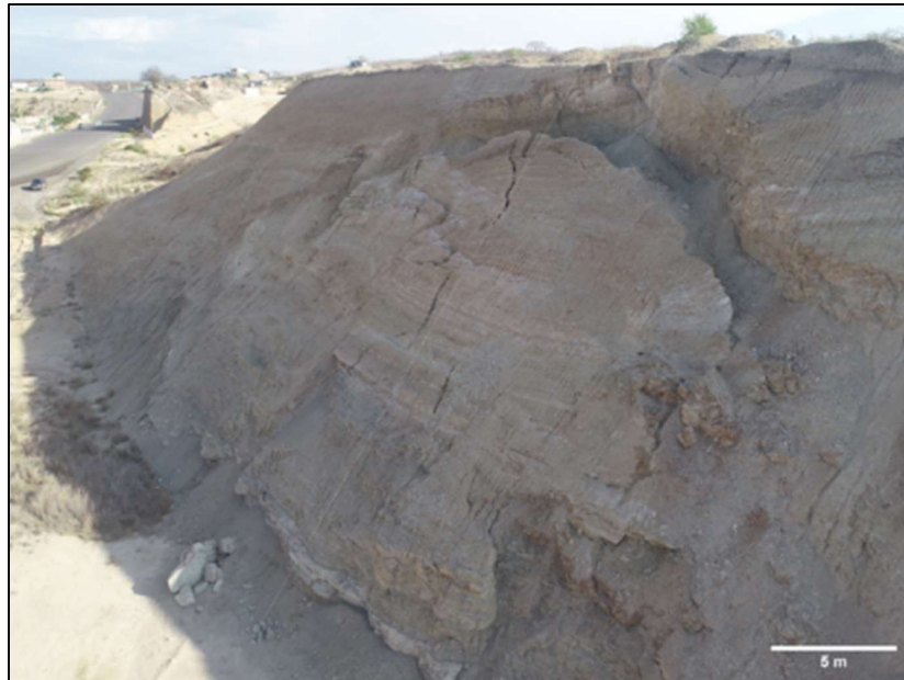
Figura 1. Falla del talud colapsado en la vía San Mateo-Santa Marianita.
