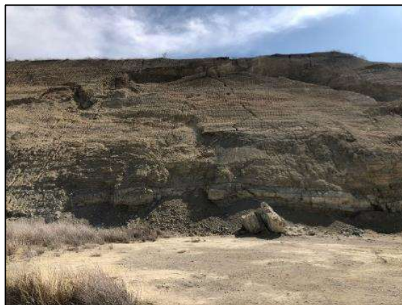
Figura 23. Materiales expuestos en el Talud Colapsado del km 1.9 del proyecto.
