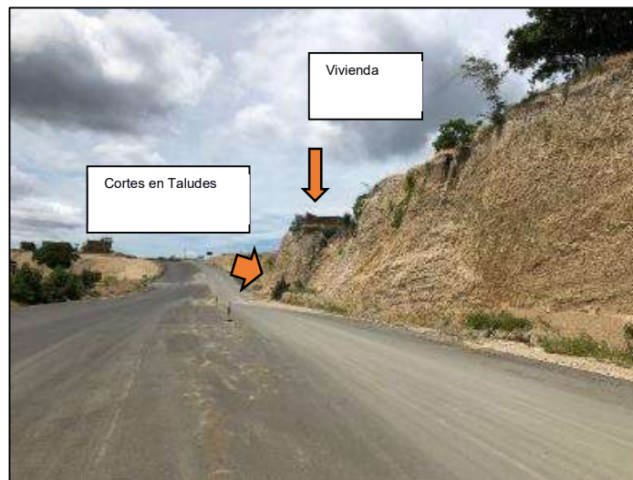
Figura 21. Taludes generados desde el km 0+900 hasta el km 1+900 de la vía San Mateo - Santa Marianita
