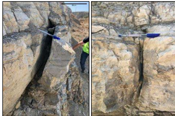
Figura 27. Diaclasas ubicadas en la parte baja del talud, en detritos de color gris.
