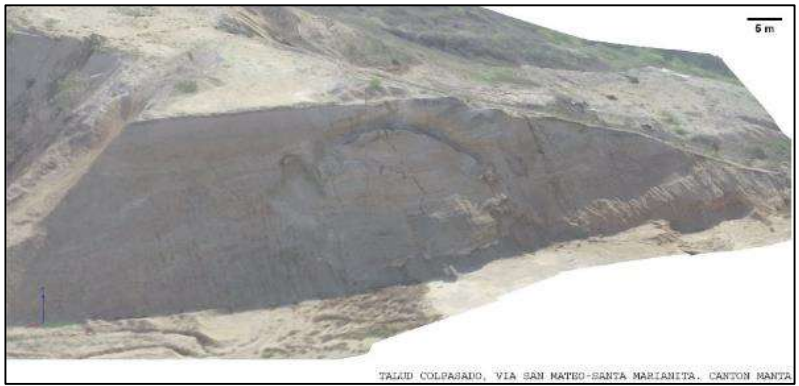
Figura 2. Talud colapsado en km 1.9 de la vía San Mateo-Santa Marianita, del cantón Manta.
