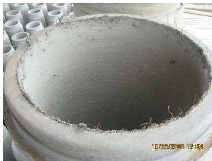
Foto 5.1.8 Fibras de acero sobresalientes en el extremo macho del tubo
