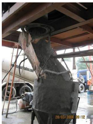
Foto 2.1.3.4 Tolva alimentadora de hormigón
