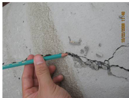
Foto 5.2.1.2 Fibras de acero actuando en las fisuras para impedir la separación total del elemento en la zona de rotura
