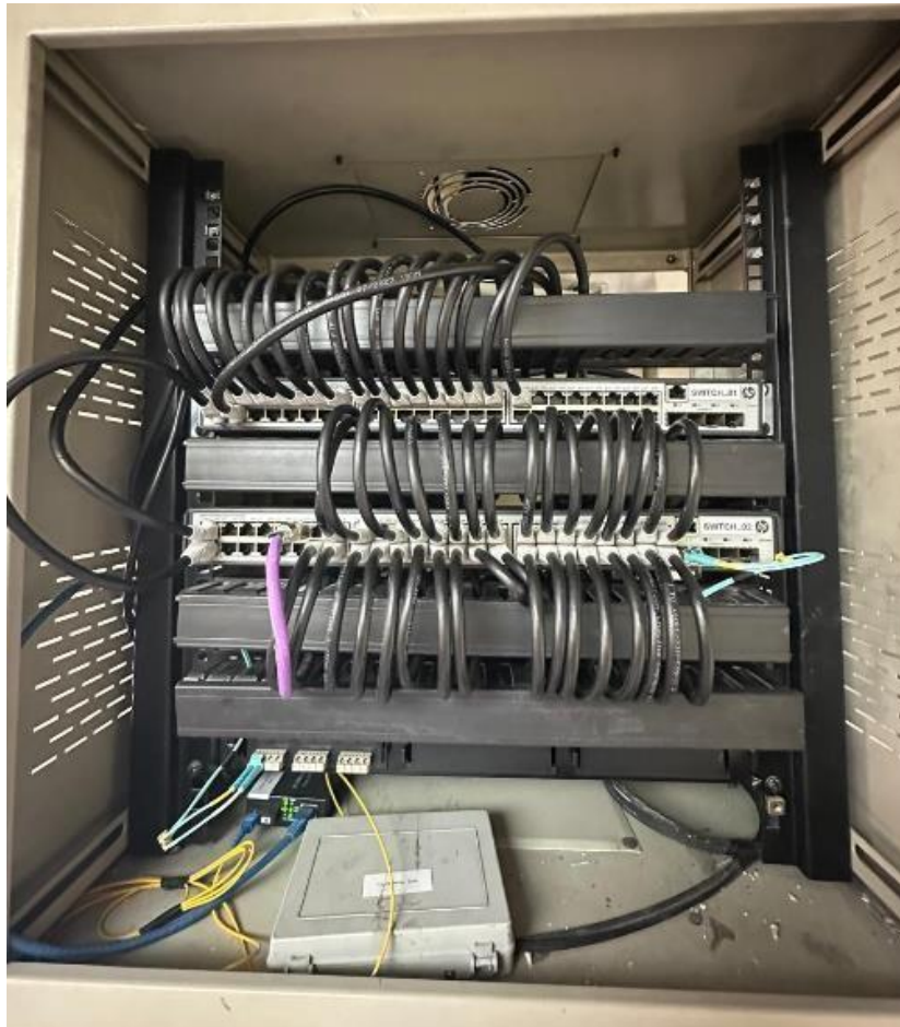
Ilustración 50 Rack en Laboratorio de Computación en Unidad Secundaria (Zapata José)
