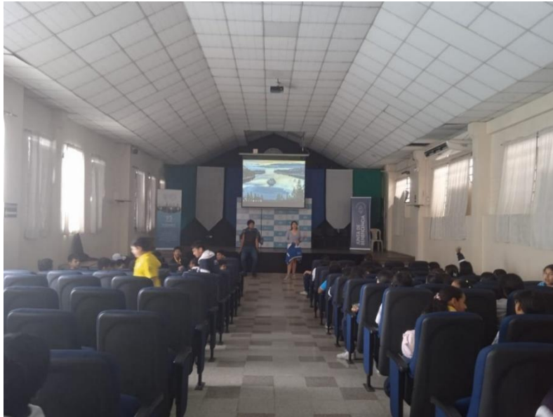
Ilustración 59 Instalación de un Access Point Ruckus en el auditorio (Zapata José)
