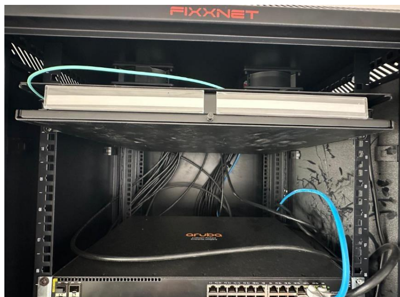
Ilustración 46 Switch HP Aruba con su modulo de Fibra en Educación Primaria (Zapata José)
