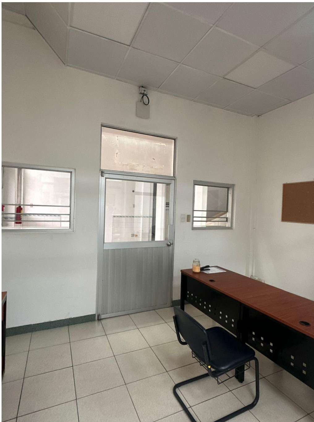
Ilustración 44 Access Point Ruckus en Área de Administración (Zapata José)
