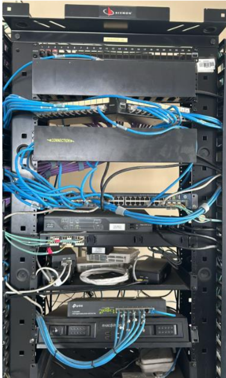
Ilustración 24 Datacenter de la Unidad Educativa (Zapata José)
