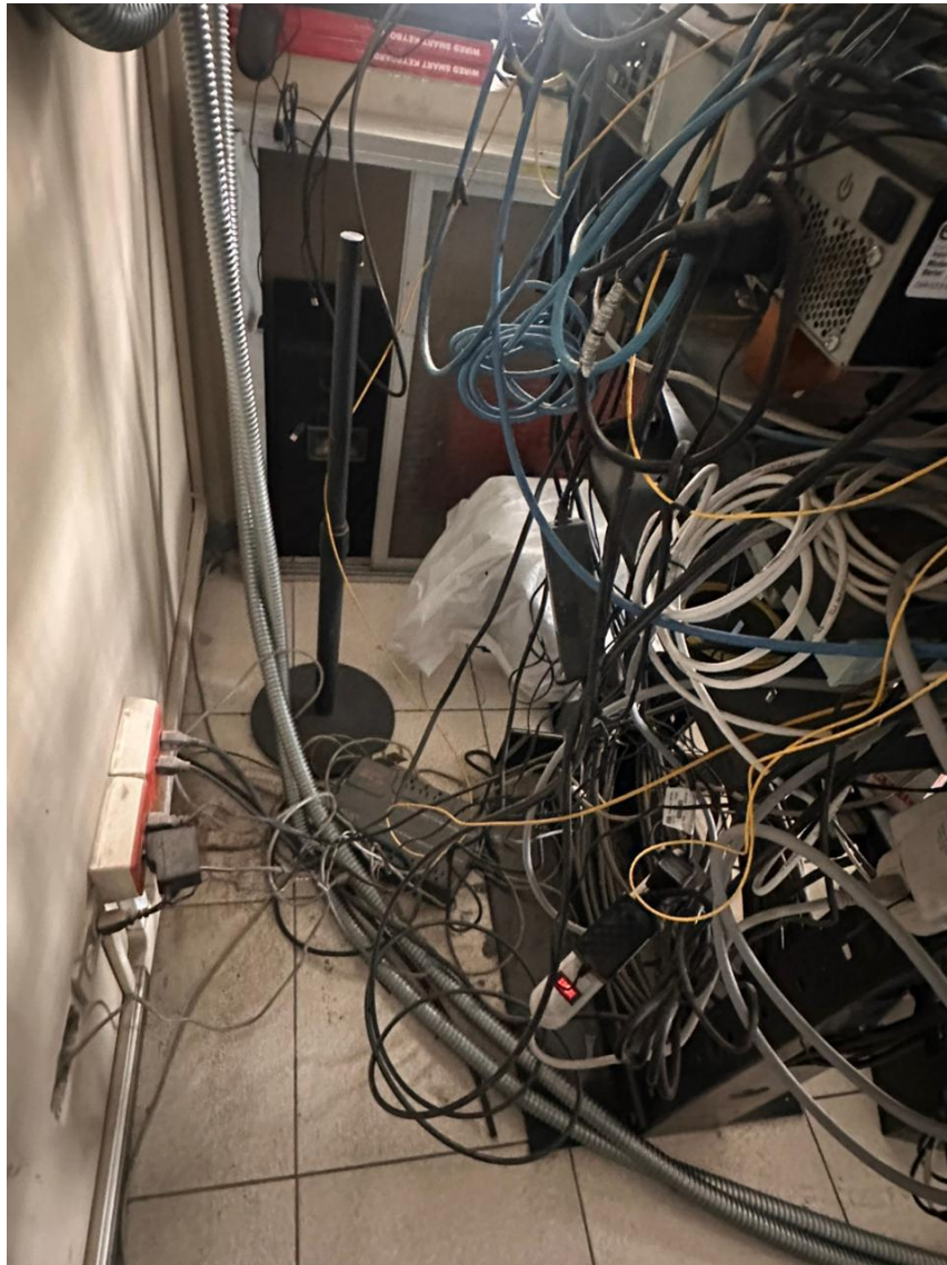
Ilustración 34 Estado Actual del Datacenter (Zapata Jose)
