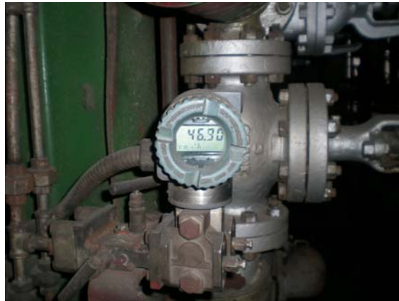
Fig. # 3.1 Transmisor de flujo de vapor de Caldera 1.
