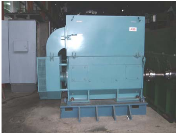
Fig. 4.11 Motor eléctrico de molinos.
