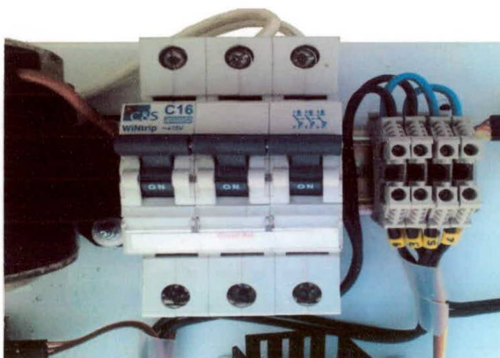
FIGURA 3.4: IMPLEMENTACIÓN DE PROTECCIÓN ELÉCTRICA
