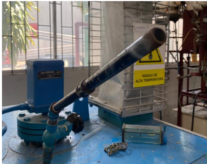
Fuga de vapor en llave de caldera
