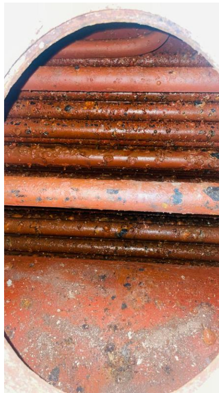
Incrustaciones en tuberías de caldera.
