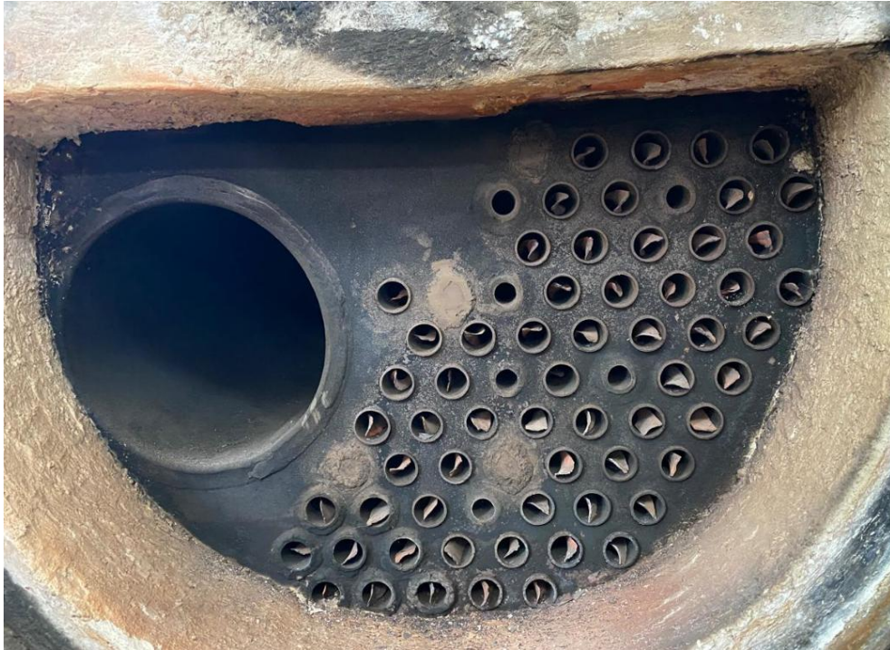
Estado actual de tubos de humo
