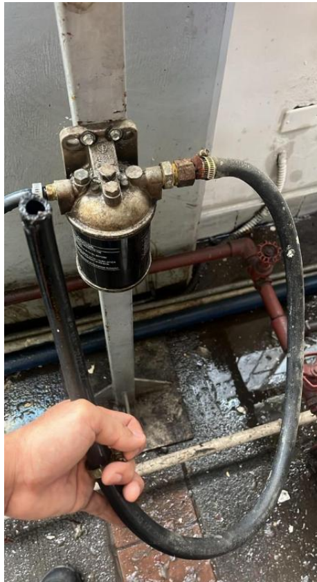
Maguera de transporte de combustible
