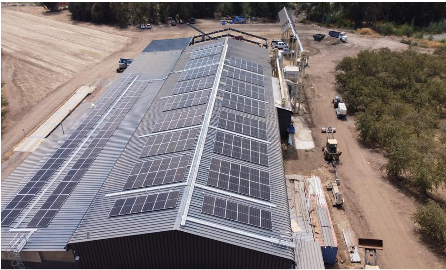
Figura 2. Ejemplo de cubierta con paneles solares
