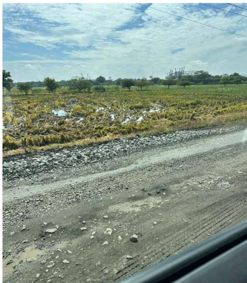
Figura 6. Presencia de “baches, hundimientos”.
