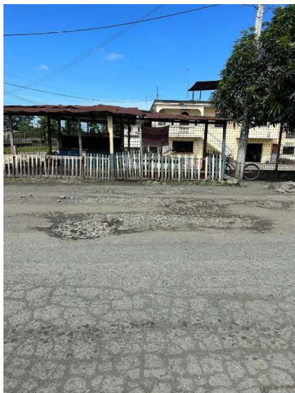
Figura 4. Estado actual de la vía baches tapados con piedras.
