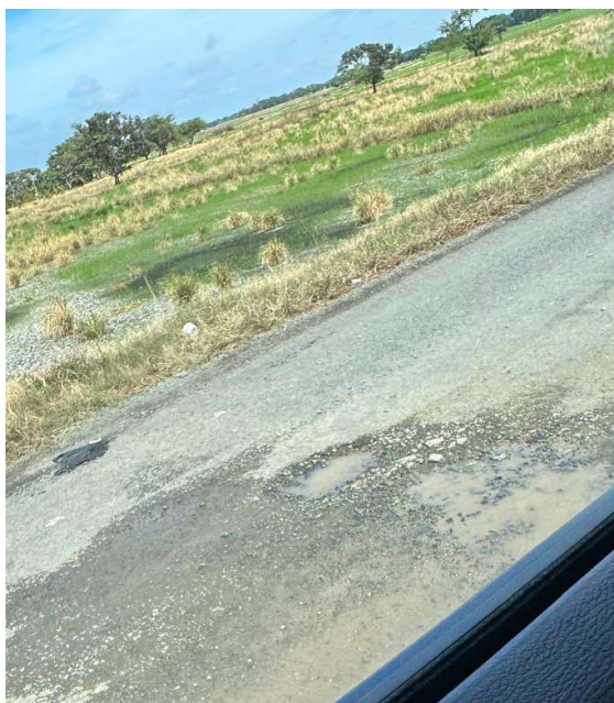
Figura 7. Presencia de “Piel de cocodrilo y baches”.
