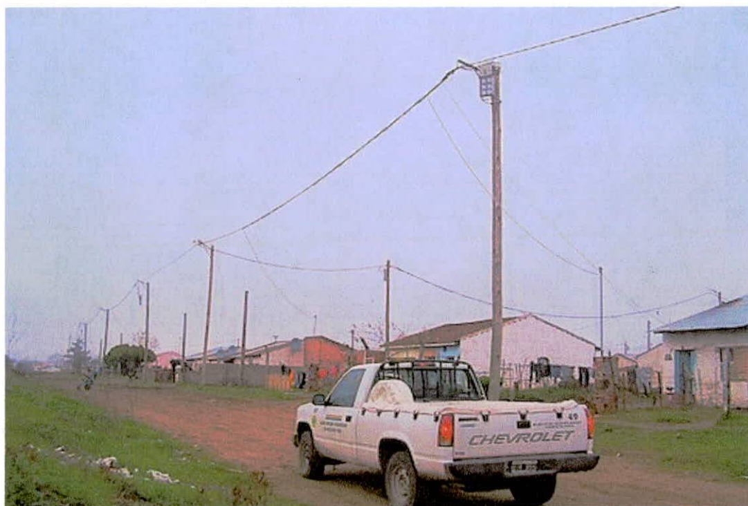
Gabinete para varios medidores colocados en altura.
