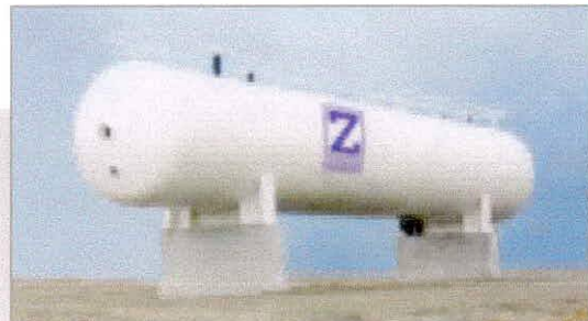
Depósito para GLP de 118 m 3
