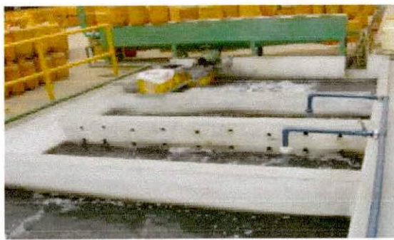
FOTO 3: PISCINA DE TRATAMIENTO DE AGUA USADO PARA LIMPIAR INTERNAMENTE LOS CILINDROS
