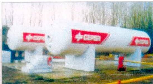
Depósito de GLP de 59 m 3
