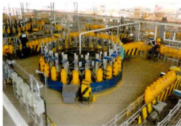
FOTO 6: SISTEMA DE LLENADO DE GLP
