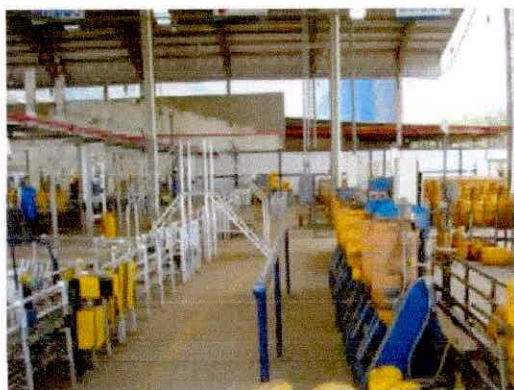
FOTO 1: LÍNEA DE EVACUADO MANUAL DE GLP
