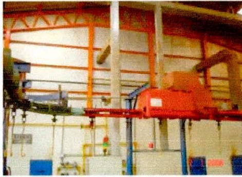
TRANSPORTADOR AEREO y línea de GLP vapor
