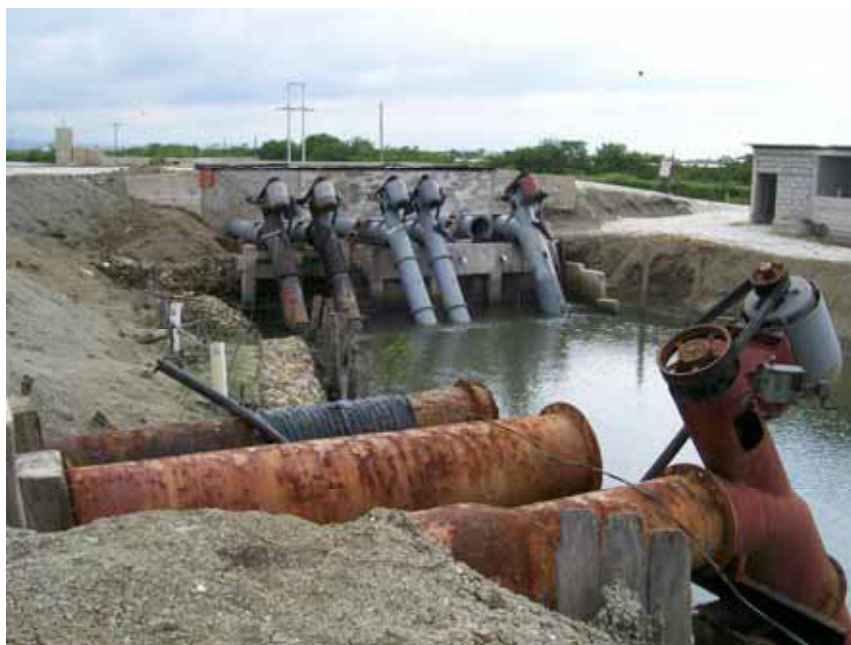
Imagen 7.- Sistema de bombas Axiales de la camaronera Langostinos.
