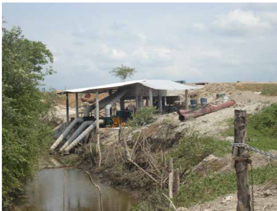
Imagen 6.- Sistema de bombas centrifugas de la camaronera Tinoco.
