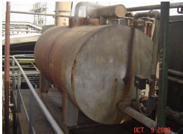
FIGURA 2.34 TANQUE RECOLECTOR DE CONDENSADO DE LA PLANTA BATCH Y CONTINUA
