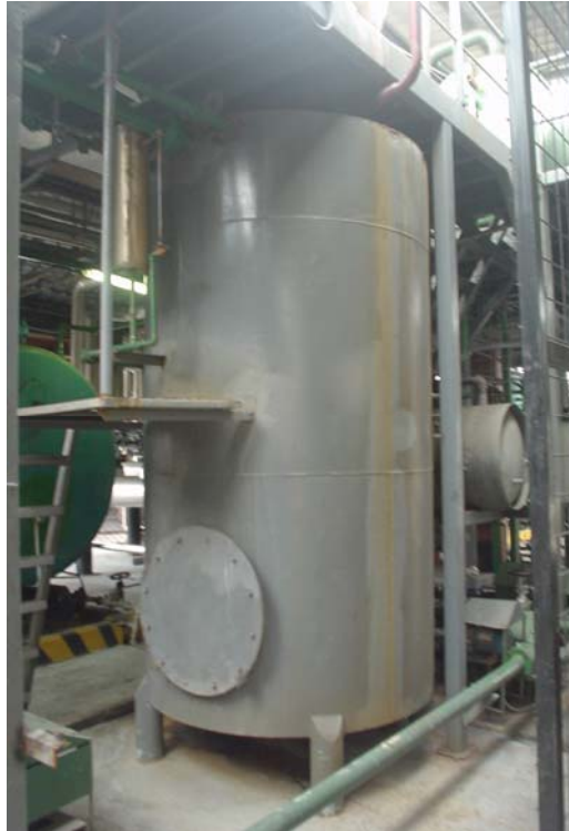
FIGURA 2.30 TANQUE RECOLECTOR DE CONDENSADO VERTICAL
