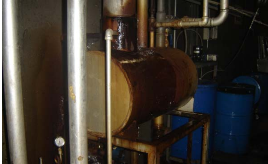
FIGURA 2.33 TANQUE RECOLECTOR DE CONDENSADO PLANTA CONTINUA
