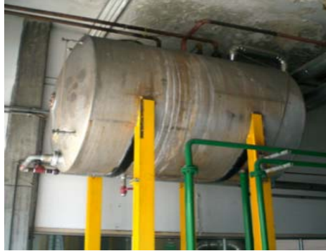
FIGURA 1.12 TANQUE RECOLECTOR DE CONDENSADO
