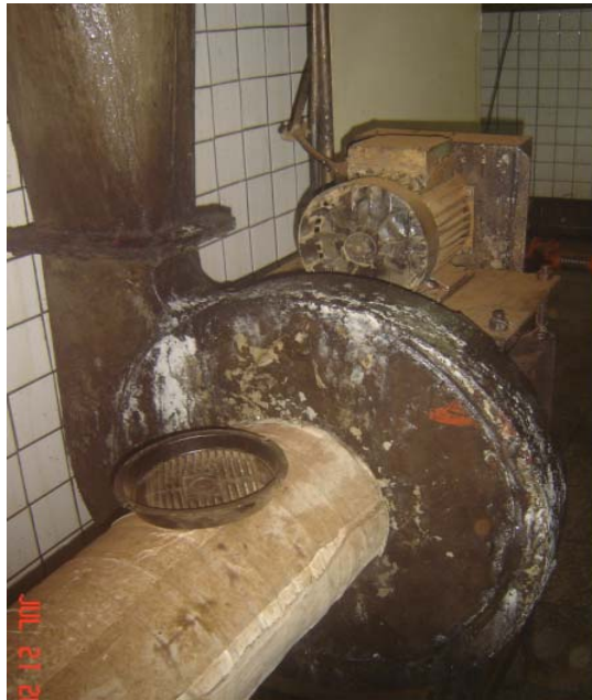
FIGURA 2.10 VENTILADOR DE AIRE CALIENTE DEL VIBROFLUIZER
