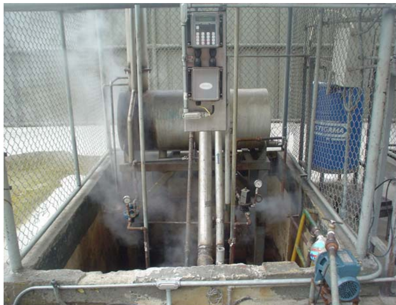
FIGURA 2.28 TANQUE RECOLECTOR DE CONDENSADO
