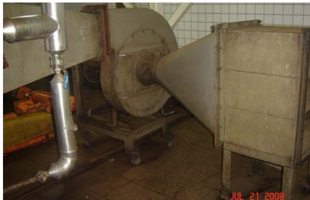
FIGURA 2.9 VENTILADOR DE AIRE CALIENTE DEL VIBROFLUIZER
