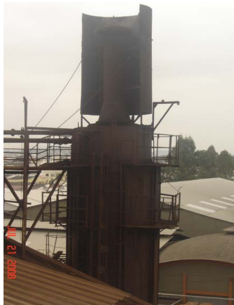
FIGURA 2.20 SILO DE BAGASO
