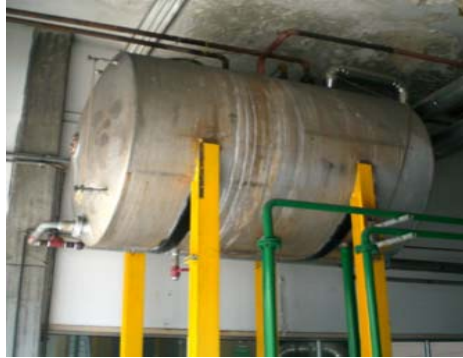
FIGURA 1.12 TANQUE RECOLECTOR DE CONDENSADO
