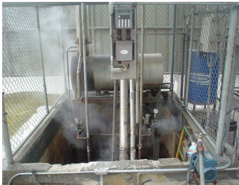
FIGURA 2.28 TANQUE RECOLECTOR DE CONDENSADO
