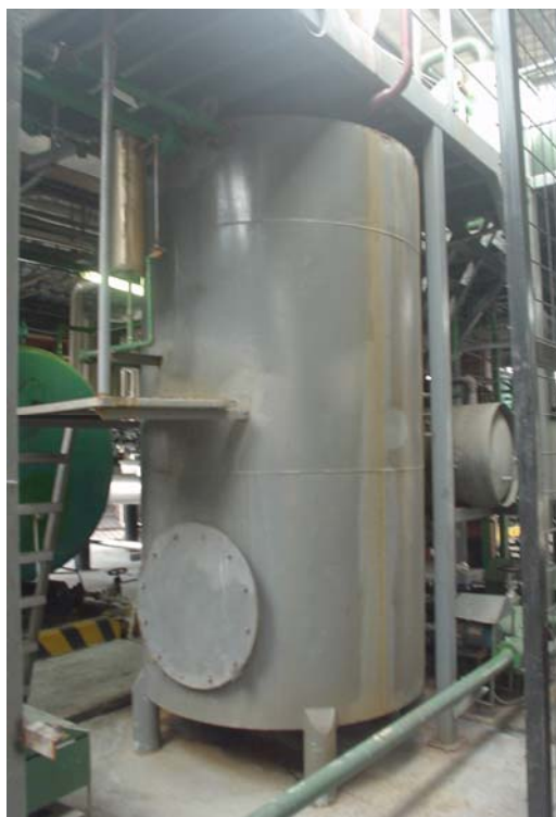
FIGURA 2.30 TANQUE RECOLECTOR DE CONDENSADO VERTICAL
