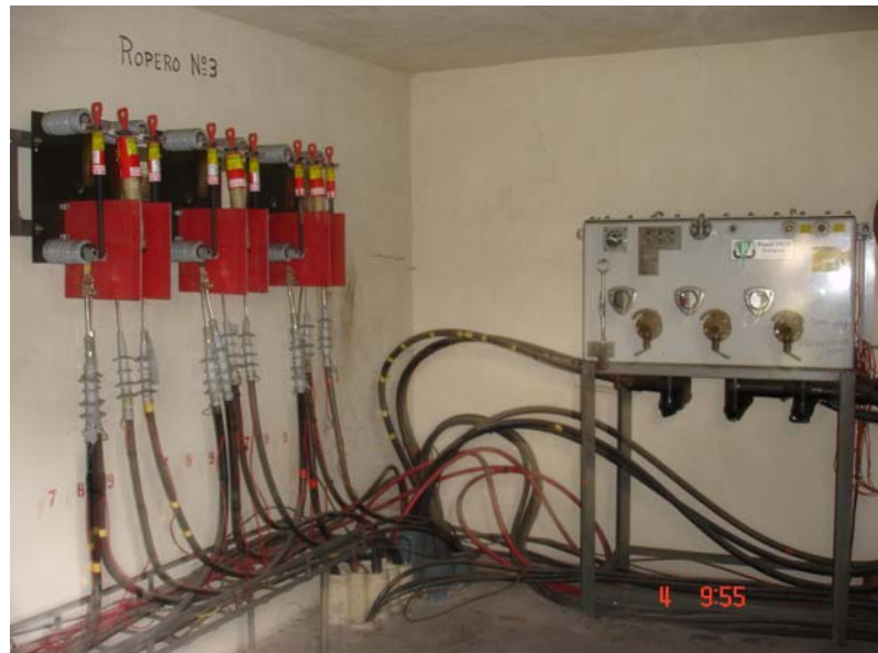
a. Conductores, Switch y fusibles
