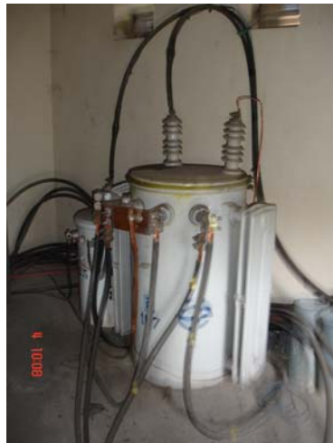
b. Transformador de distribución
