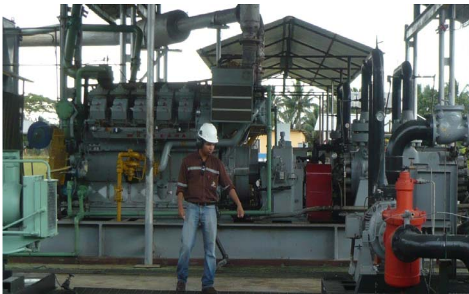
Fig.2.15. BOMBA DE SUPERFICIE. Se observa una bomba de desplazamiento positivo. Localizadas en la Estación Sacha Sur. Por Carlos Ortiz.
