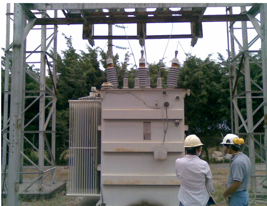
Figura #3. Subestación principal
