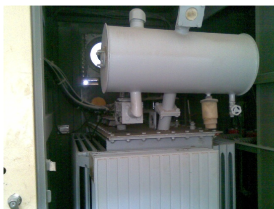
Figura #5 Transformador de la subestación "Trituración Primaria"
