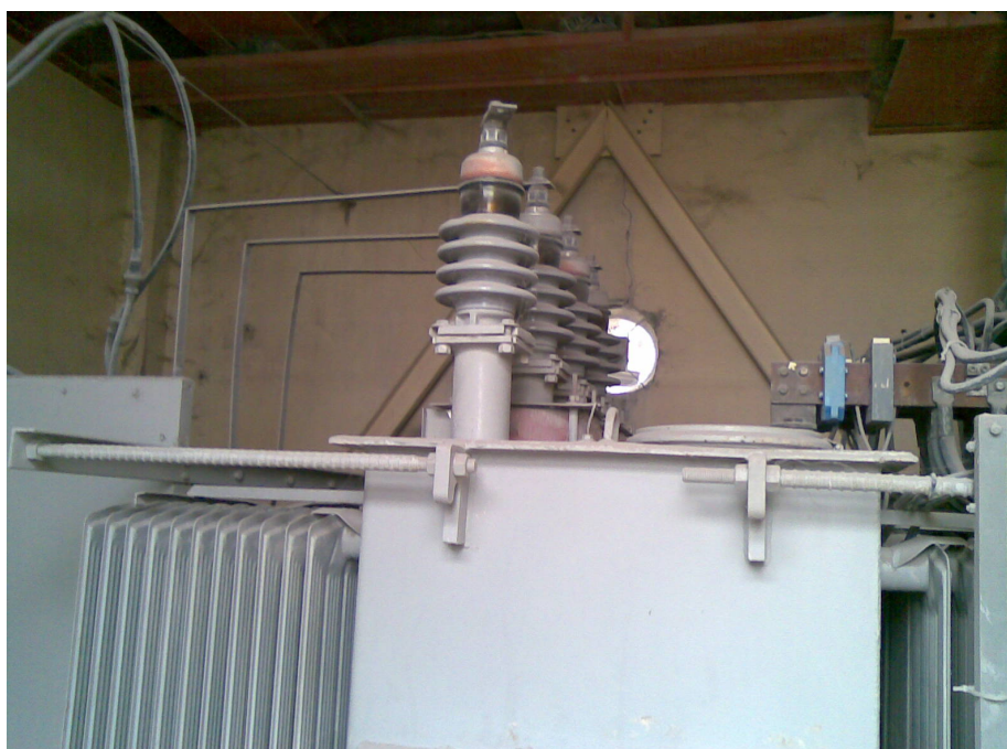
Figura #8 Transformador de la subestación “Trituración Secundaria”
