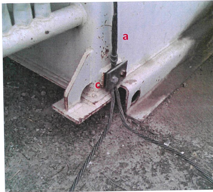
Figura #1 Toma de puesta a tierra del Transformador principal (3750 KVA)
