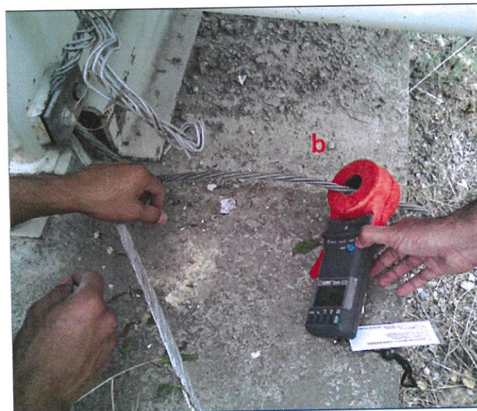
Figura #2 Toma de puesta a tierra del Transformador principal (3750 KVA)
