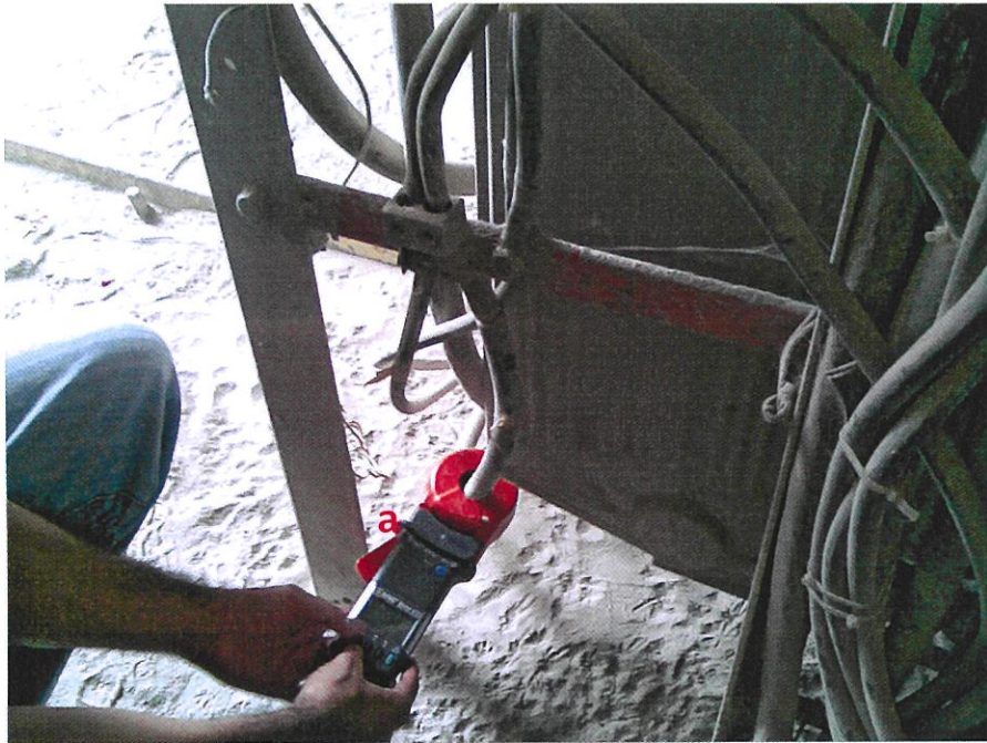
Figura #4 Toma de puesta a tierra del Transformador de Trituración secundaria (2000 KVA)
