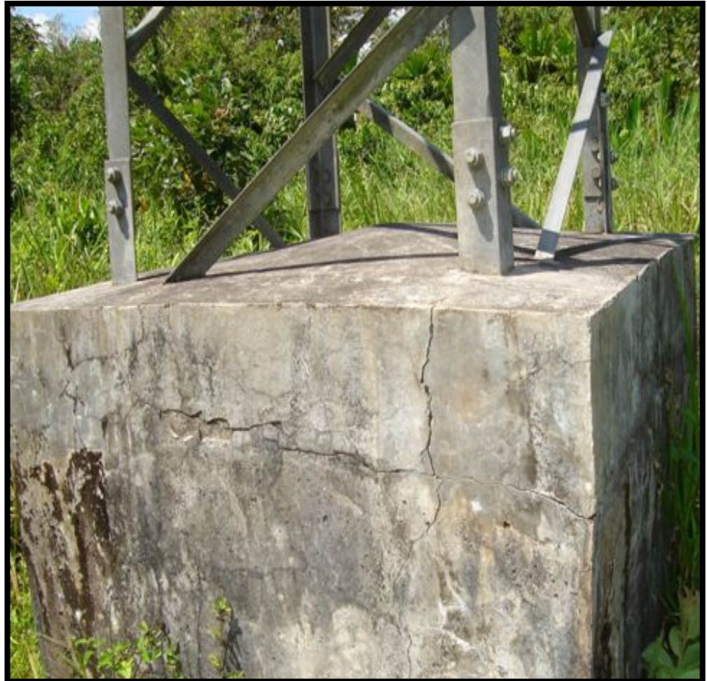
FIGURA 1.3 CORROSION DEBIDO A FISURAS EN BASE DE HORMIGON
