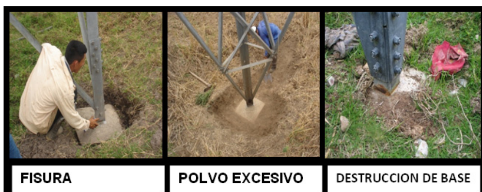
FIGURA1.7 BASES DE HORMIGON CON CORROSIÓN
