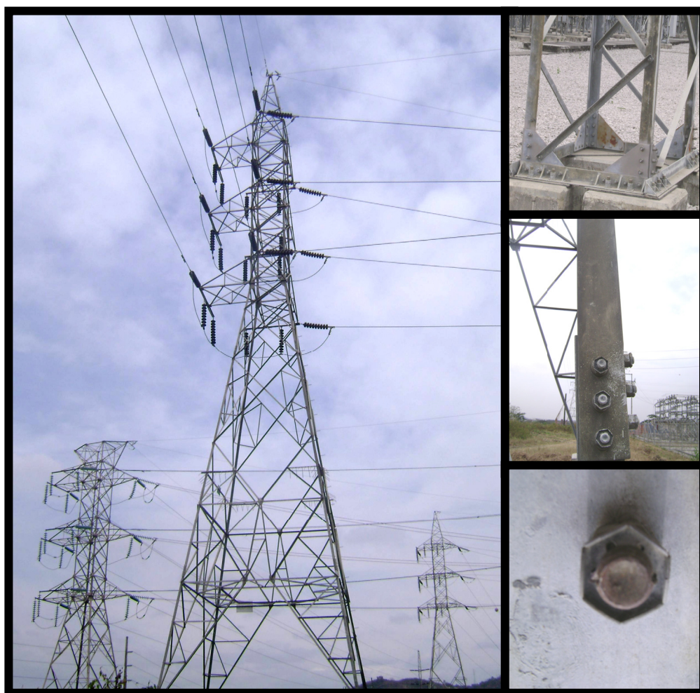
FIGURA 1.2 PARTES AFECTADAS POR LA CORROSION
