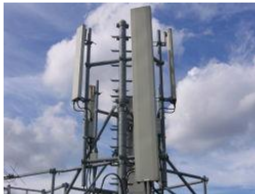
Fig. 2.3. Celda instalada en el techo de un edificio.
