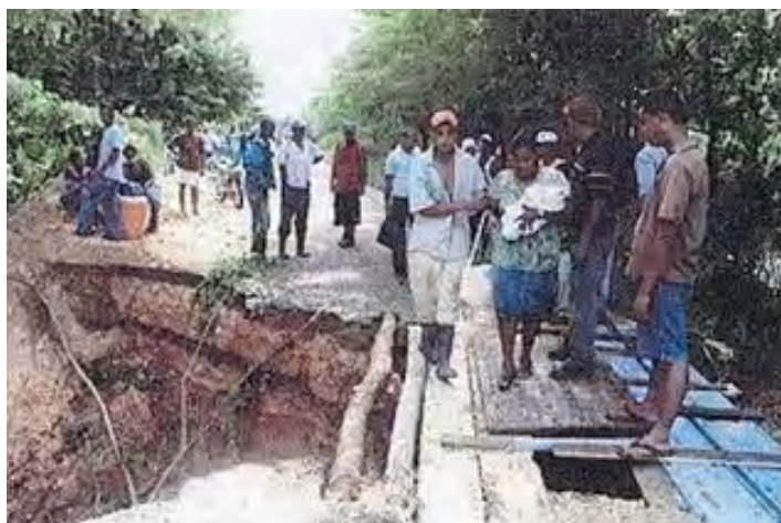
Figura 4.1 Consecuencias de no llevar un mantenimiento de alcantarilla
