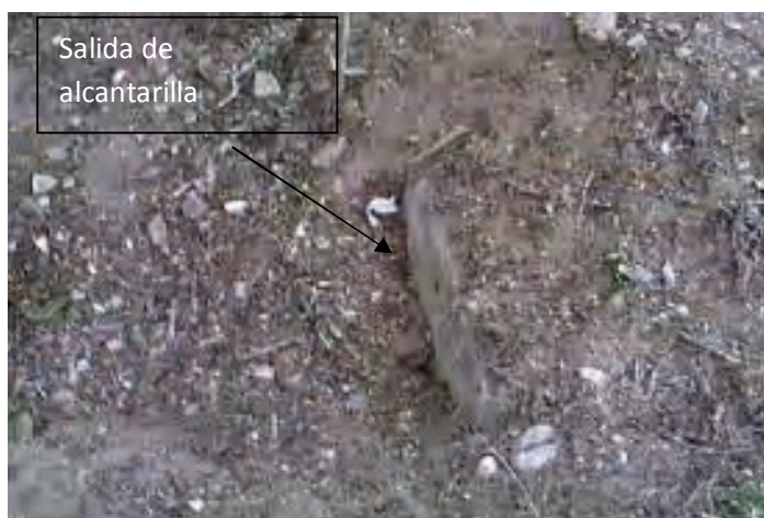
Figura 4.2 Alcantarilla tapada con sedimentos
