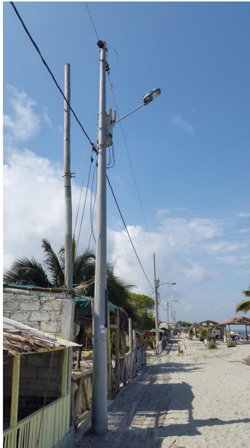
Ilustración 25. Distribución de energía eléctrica en Jambelí.
