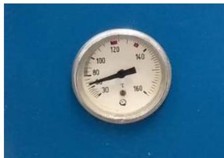
Figura 9. Control de temperatura
