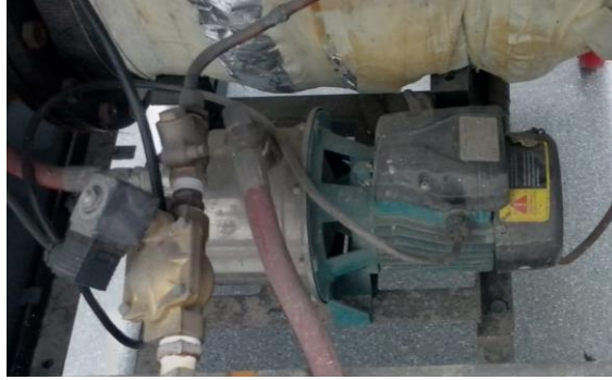
Figura 15. bomba de agua
