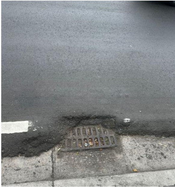
Zona 1: Juntas inapropiadas. -
