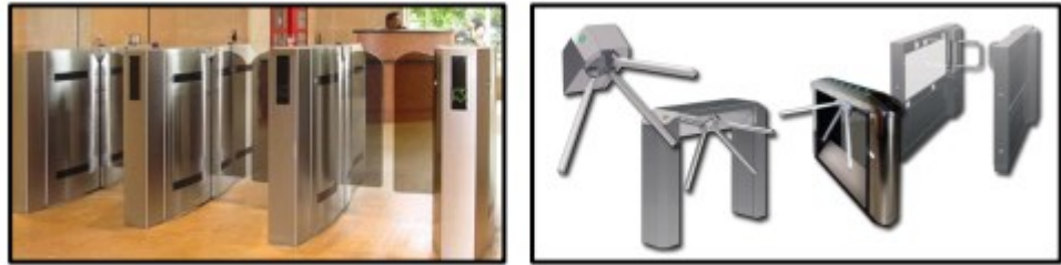
Figura 1.4.1 2 Control de acceso peatonal [(BERROCAL, 2016)]
