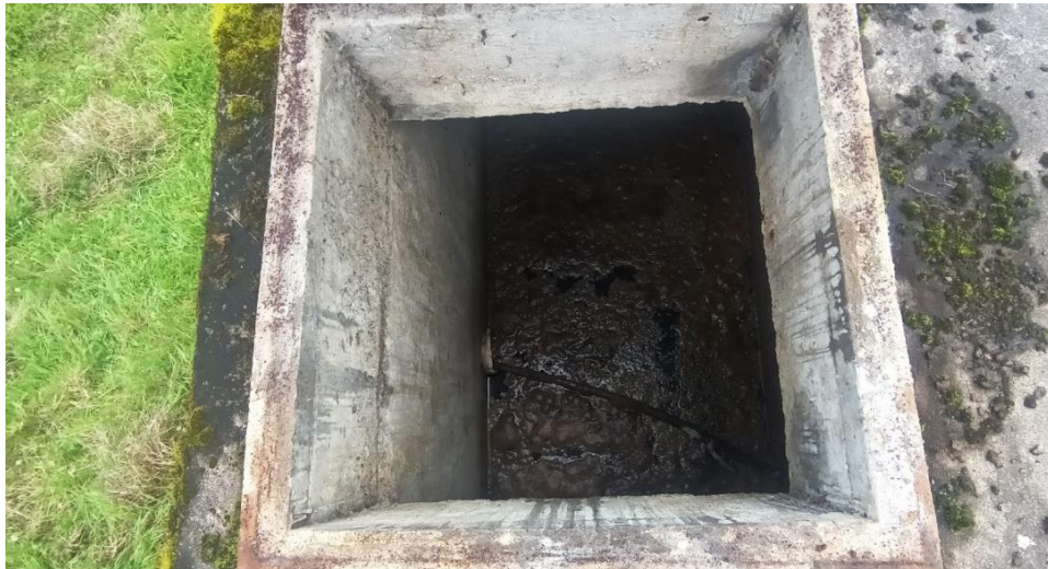
Figura 6. Salida de la PTAR.
