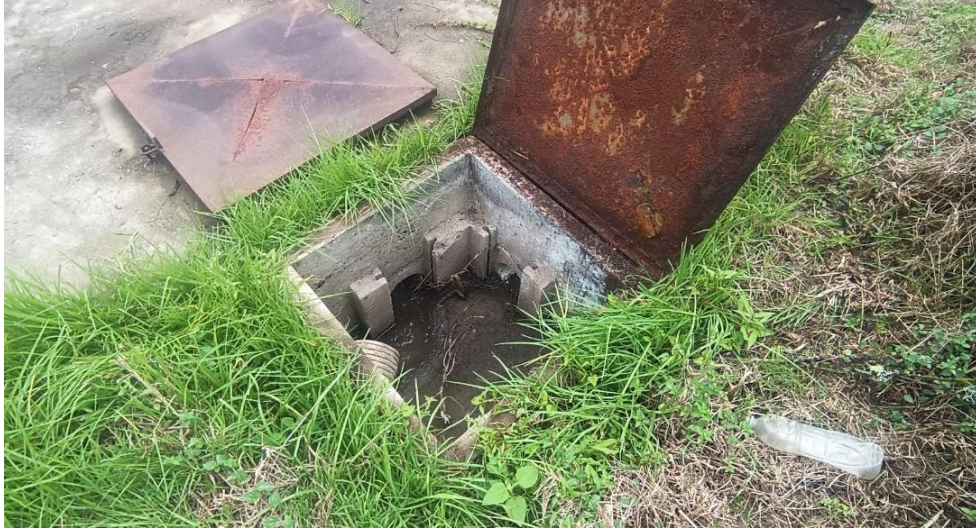
Figura 4. Ingreso a la PTAR.
