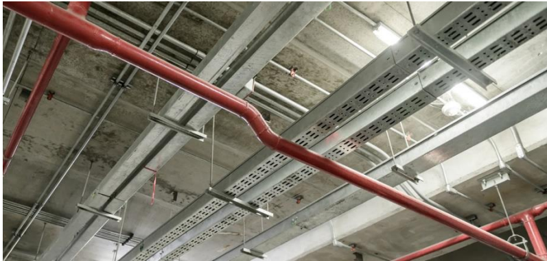
Figura 1.3: Disposición de canaletas con estructuras de soporte
