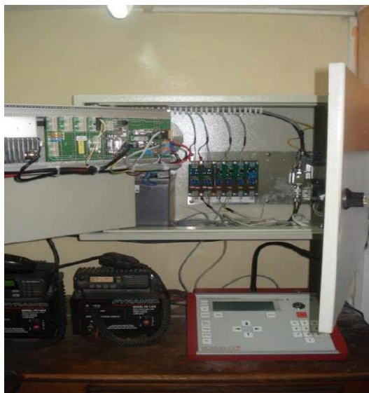
Figura 2.5 Sistema de control remoto de las sirenas [59]
