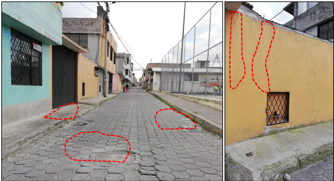
Figura 2.3 Asentamientos observados en alcantarillas, pozos de revisión y construcciones.
