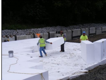
Figura 3.23 Uso de geobloques de EPS en la Intersección I-80/I-65, Gary, Indiana (Insulfoam, 2014).
