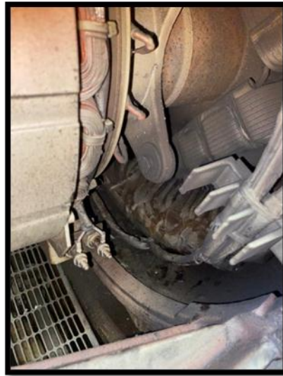
Figura 2.6 Presencia de cuerpos extraños en el generador
