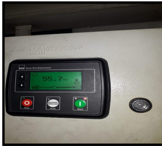
Figura 2.2 Medición de frecuencia del generador
