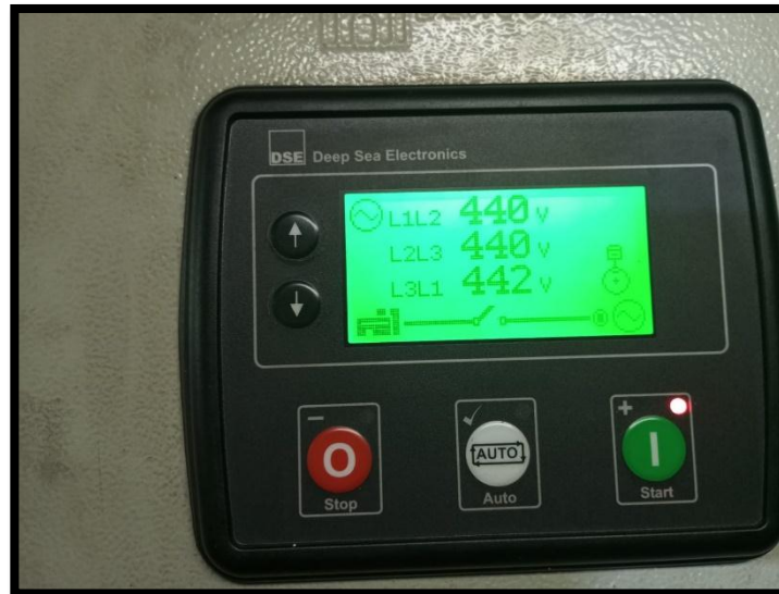
Figura 3.10 Voltaje línea a línea después del mantenimiento
