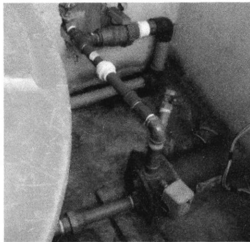
Figura. 1.4. Bomba de riego.
