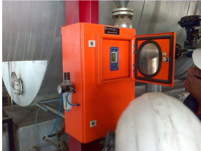
FIGURA 5.2 TABLERO DEL CONTROLADOR DEL SISTEMA AUTOMÁTICO DE PURGA DE SUPERFICIE DE CALDERO
