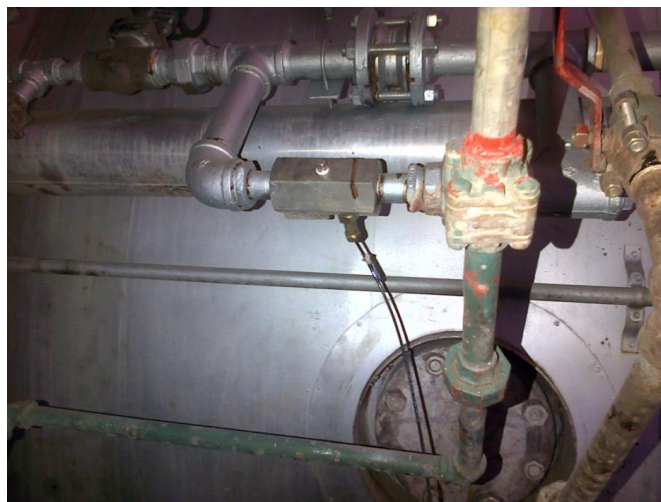
FIGURA 5.3 UNIDAD DE DETAECCIÓN DE CONDUCTIVIDAD EN LA LÍNEA DE PURGA DE SUPERFICIE, PARTE DEL SISTEMA AUTOMÁTICO DE PURGA DE SUPERFICIE DEL CALDERO.
