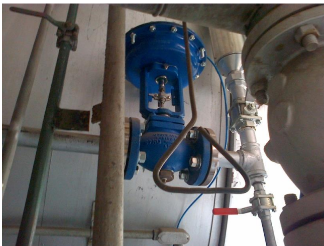
FIGURA 5.4 VÁLVULA DE CONTROL NEUMÁTICA DEL SISTEMA DE PURGA AUTOMÁTICA DE PURGA DE SUPERFICIE DEL CALDERO.
