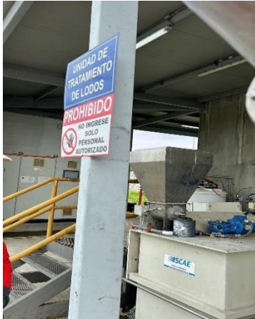
Unidad de tratamiento de lodos
