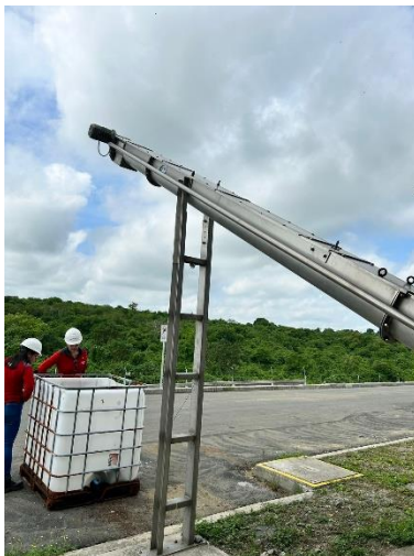
Depósito de lodos
