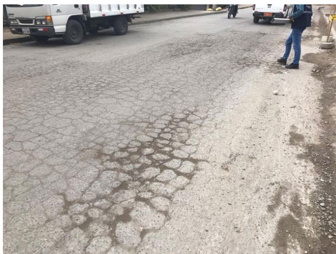
Figura 18: Agrietamiento en bloque (severidad alta).
