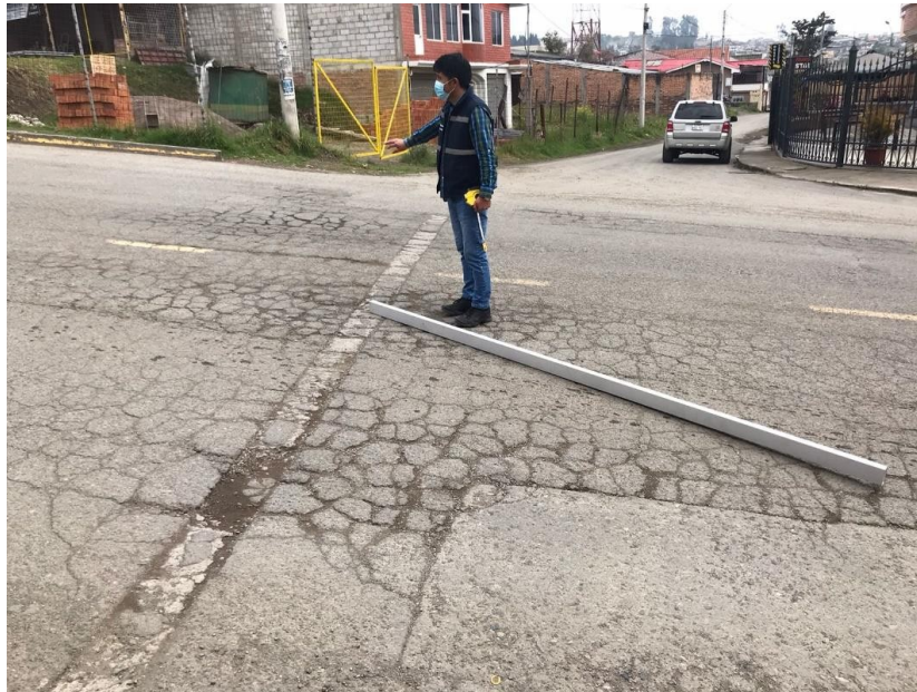
Figura 35: Estado actual de la capa de rodadura.
