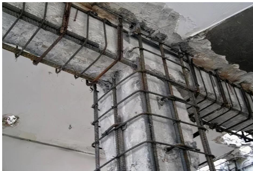
Gráfico 3.16: Encamisado en viga y columna
