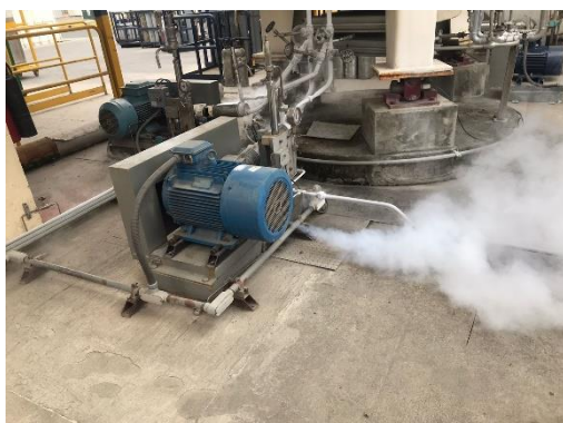
Figura 26 Fugas en bombas y tuberías
