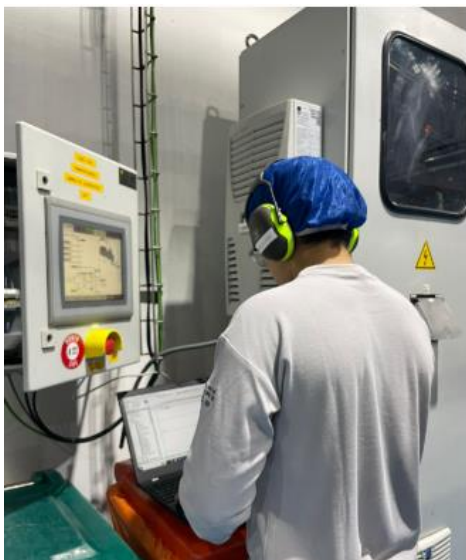
Figura 58 Operador técnico con el uso del troubleshooting ajustó la bomba de la maquina debido a la alarma presentada
