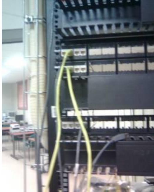
Figura 5.7 Conexión en los puertos del rack
