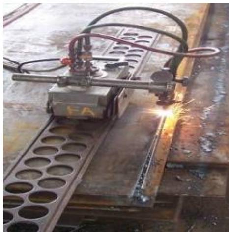
Figura 4.17 Sistema de Corte Semi-automático
